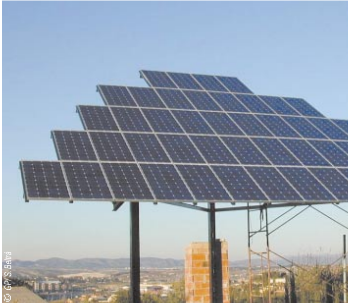
Instalación solar fotovoltaica de 5 Kw conectada a red en Ontinyent, Valencia
