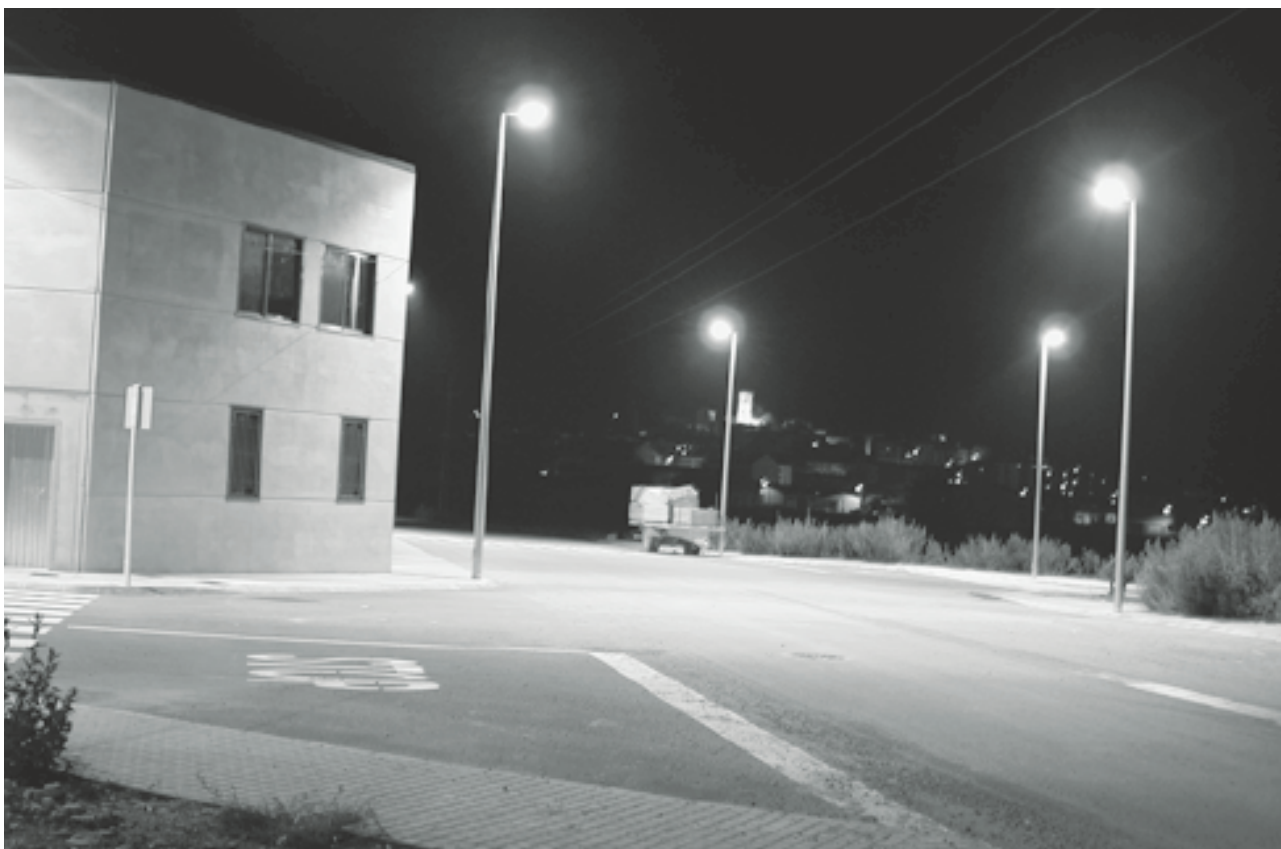
Enllumenat d'alt nivell
