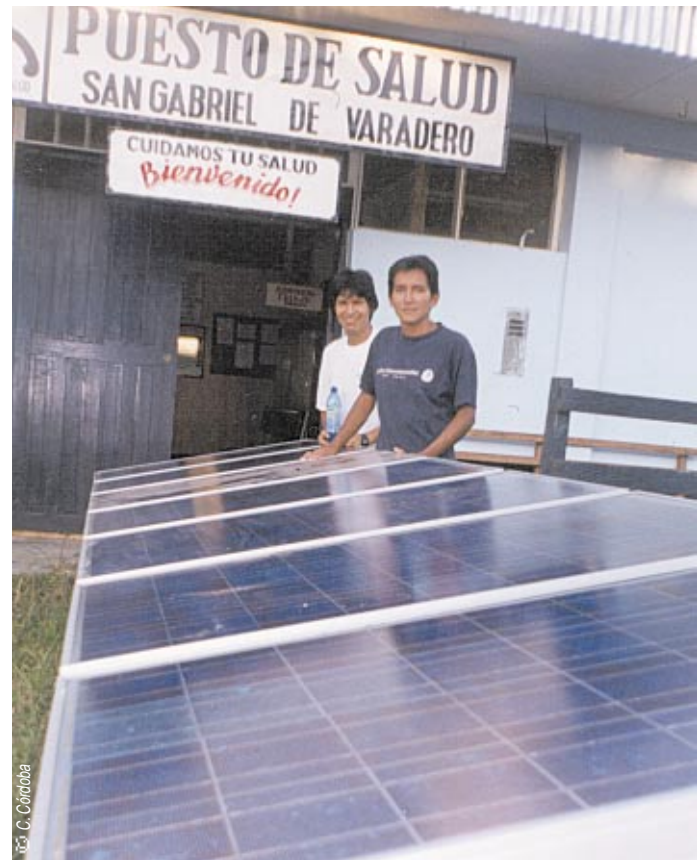
Consultorio médico en Varadero, Perú, abastecido con energía solar fotovoltaica
